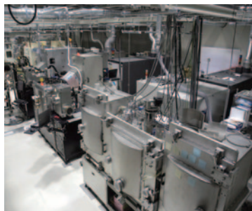
高温超電導線材作製装置群
